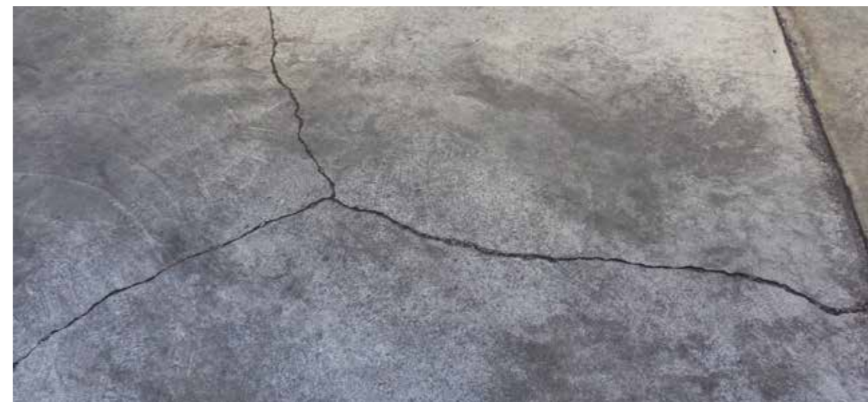
Esempi di fessurazione in una pavimentazione in CLS
