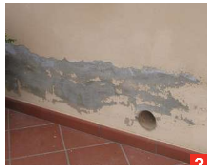
3. Zawilgocony mur - wysolenia
