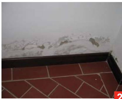
2. Zawilgocony mur ponad cokółkiem
