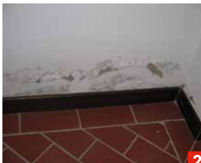
2. Zawilgocony mur ponad cokółkiem
