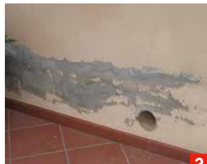
3. Zawilgocony mur - wysolenia
