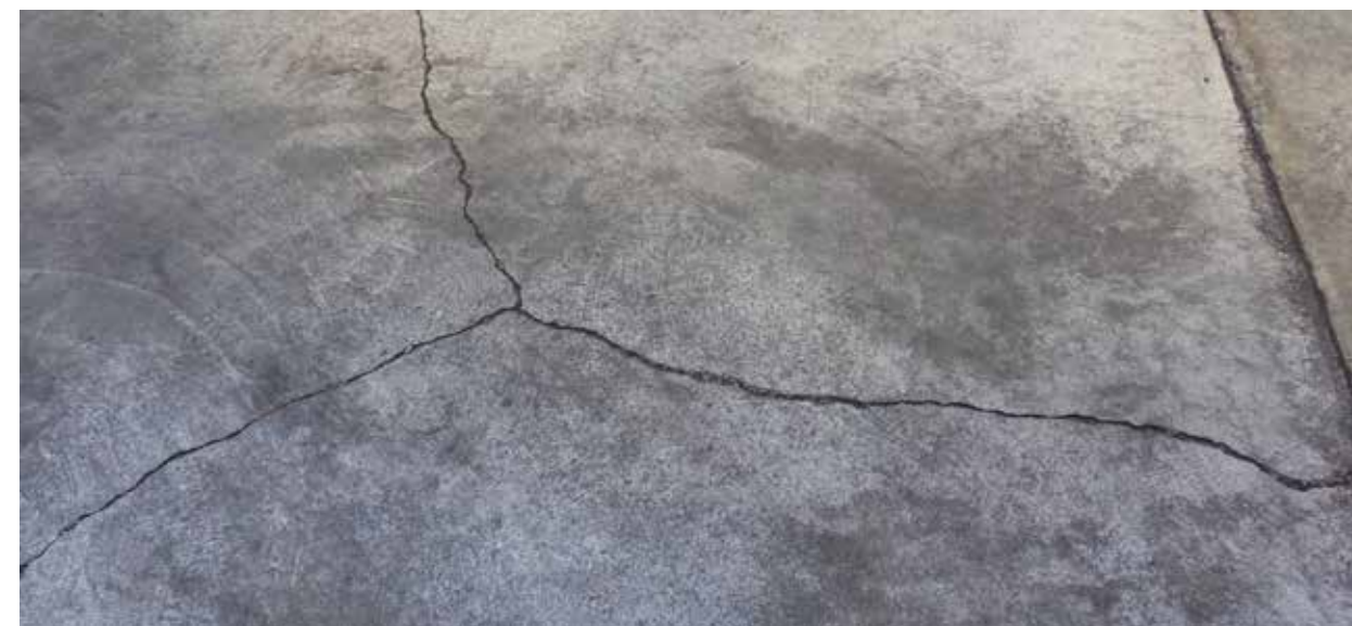
Příklady praskání v betonové vozovce
